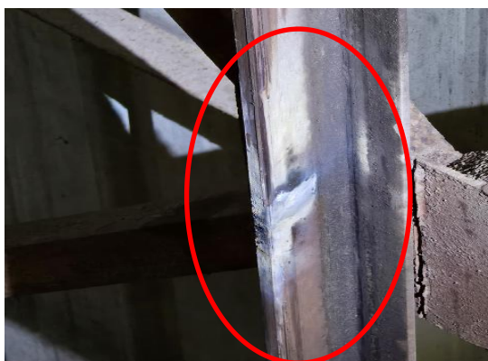
图 9 新的电焊电弧烧伤痕迹
