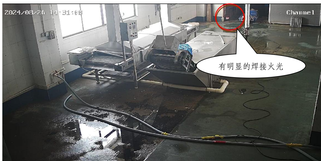
图4 井道左侧有明显的电焊火光
