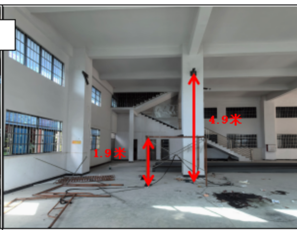
图4 事故现场脚手架、T型固件高度 (拍摄于事故位置西北侧)
